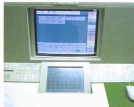
■消防緊急指令台
