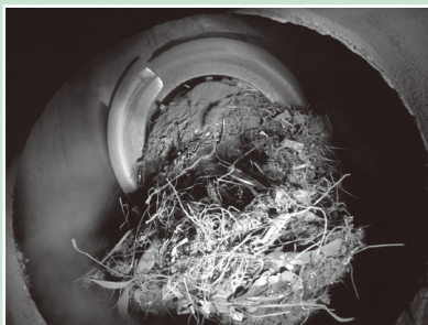
緊急停止の原因に至った金属の詰まり
