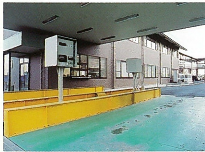
■ごみ計量機 収集車で運ばれてきたごみを計量します。
