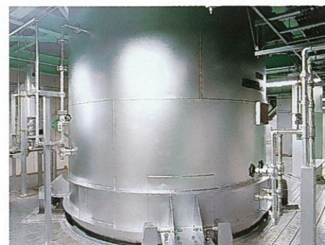
■カーボン貯留ホッパ 燃焼溶融工程へ送るカーボンを貯留します。
