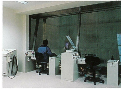
■クレーン操作室 ごみピットに貯留されたごみをクレーンを使用してホッパへ投入します。
