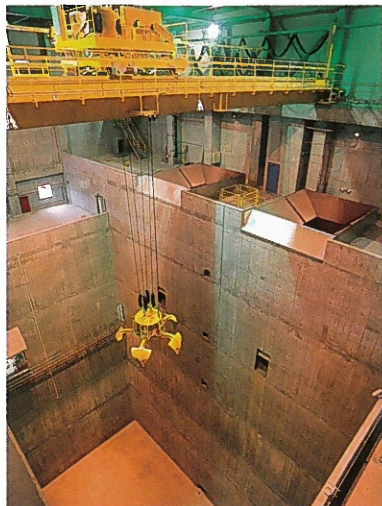
■ごみピット・クレーン・ホッパ 運び込まれたごみは一時ごみピットに貯留されます。ここにはおよそ600トンのごみを貯留できます。
